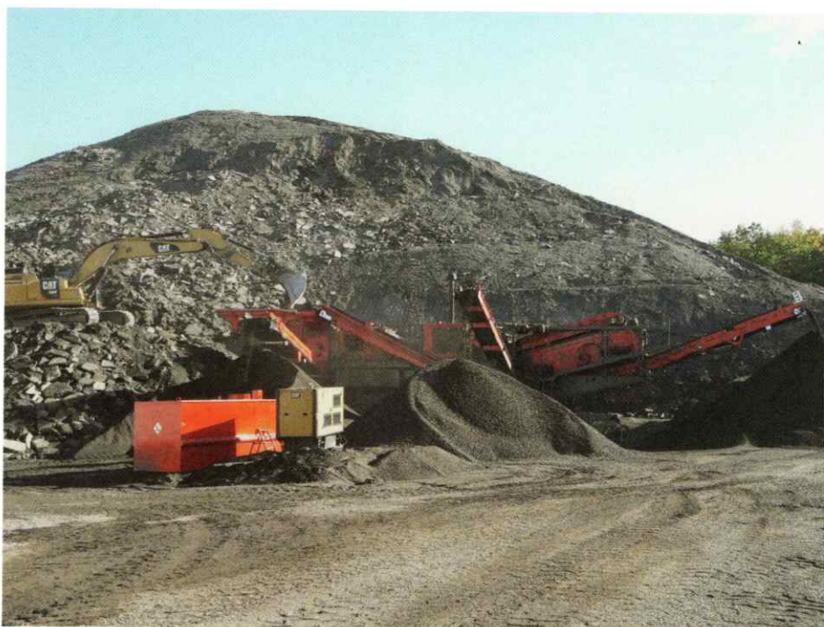
Ressourcenverschleiss: Jedes Jahr landen 750 000 Tonnen Ausbruchasphalt auf Deponien. Foto: Empa
